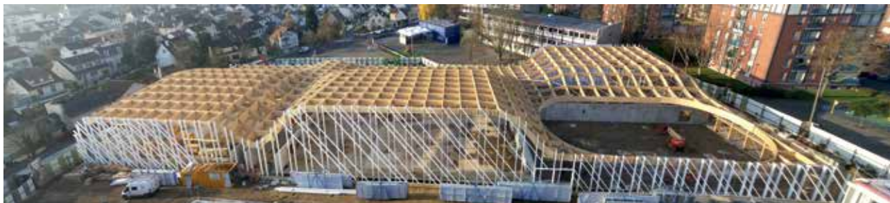
Die Dachkonstruktion des Sportparks Campus Trivaux-Garenne mit weichen Übergängen zwischen den verschiedenen Höhen der gitternetzartigen Dachkonstruktion. Sie wurde mit einem 3D-CAD-Programm modelliert.
