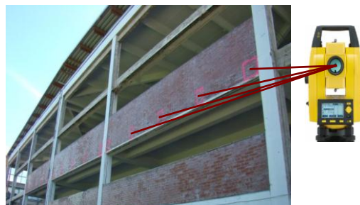
Figure 16: Repérage des positions d'ancrage par tachéomètre, sur la base du fichier CAO / Cadwork Leica Builder
