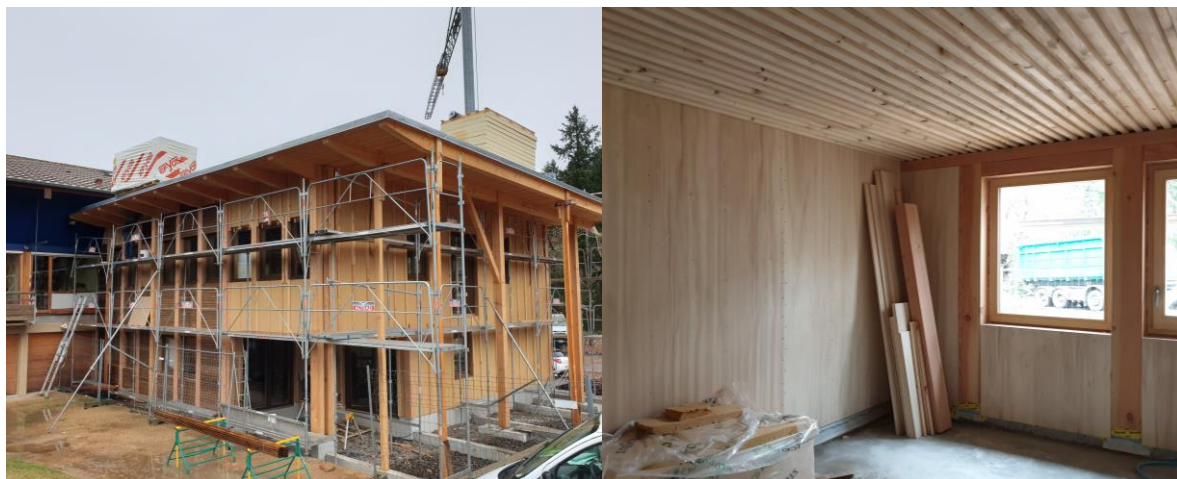
Figure 5 : Photo de l'extension de bureaux, bardage Douglas en cours de pose et photo de l'un des bureaux
