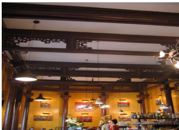
Café Le BATACLAN conservation et adaptation du plancher haut (classé MH), par connections par le dessus
