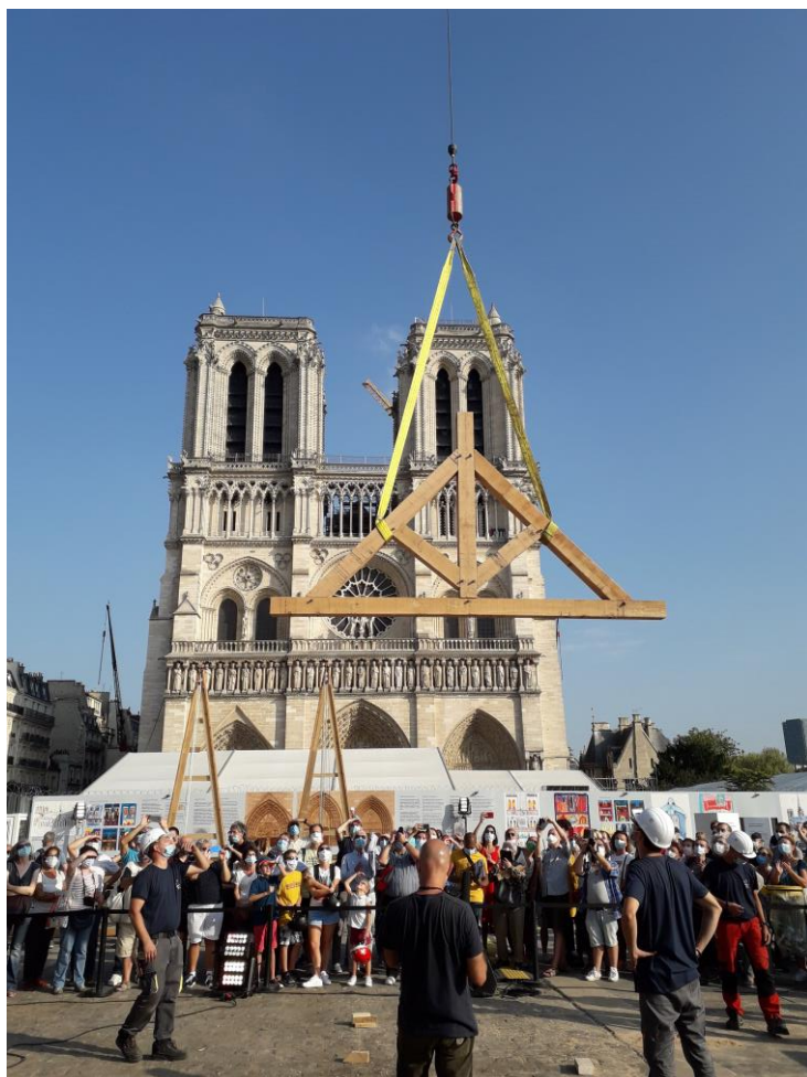
Levage d'une ferme en chêne sur le parvis de Notre Dame de Paris JEP 2020. Crédit photo « iccb »
