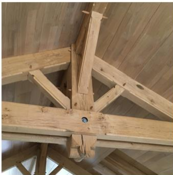
Sapisol Sous face Chêne panneauté sur charpente en chêne Massif
