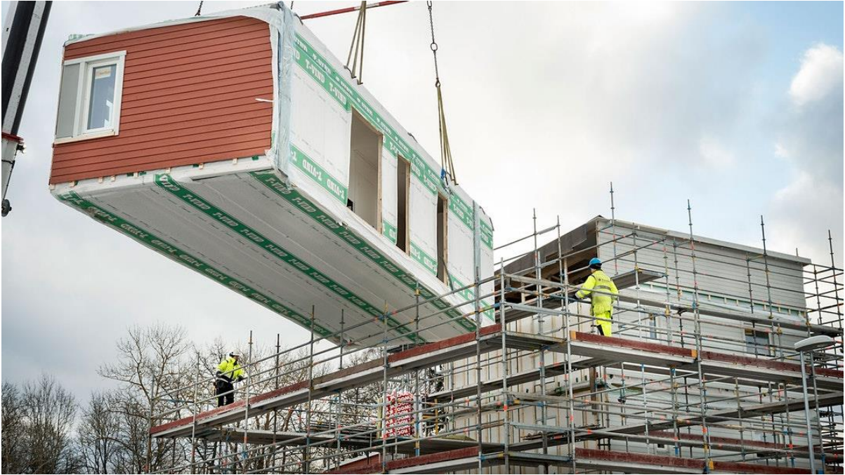
Figure 5 : préfabrication des modules de logements en usine et montage (© AIX et ©Setra)
