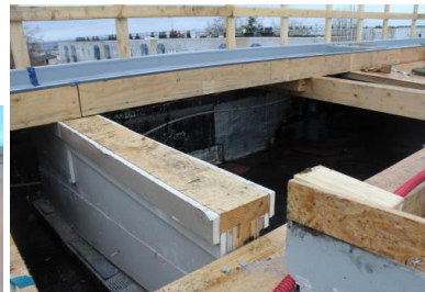
Murs coupe-feu et passerelle préfabriquée
