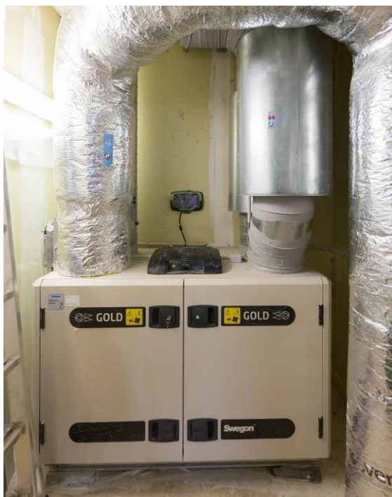
Figure 12 : Centrale ventilation double flux (Photo Steven Morlier pour IZUBA énergies)
