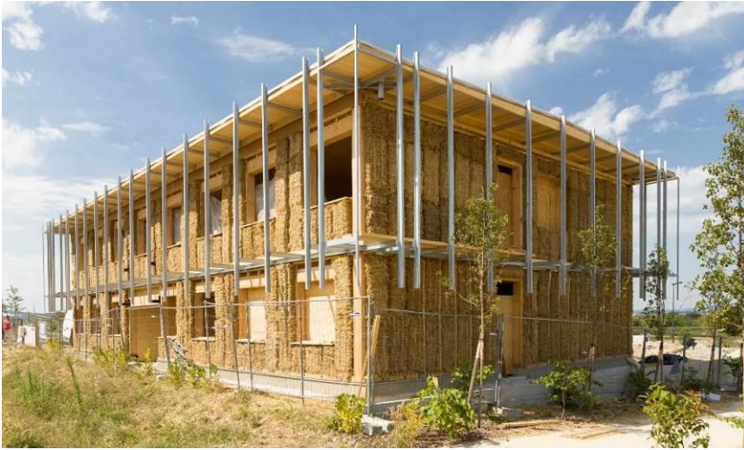
Figure 6 : Vue de l'ossature bois en cours de chantier (Photo Steven Morlier pour IZUBA énergies)
