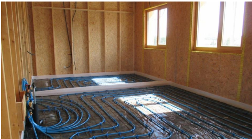
Figure 11 : Plancher chauffant-rafraîchissant (Photo IZUBA énergies)
