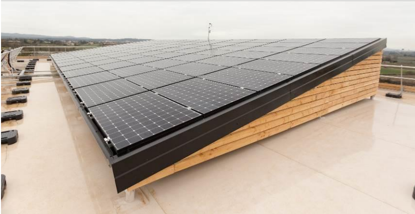
Figure 13 : Solaire photovoltaïque (Photo Steven Morlier pour IZUBA énergies)
