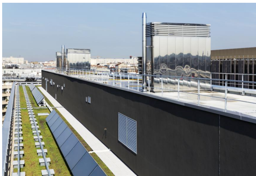
Illustration 18 : cheminées thermiques ©Michel Denancé
