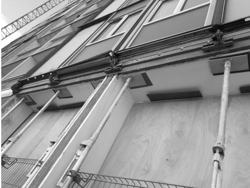
Figure 2 : Dépose de la façade existante. On voit en haut les panneaux de façade partiellement déposés, avec leurs cadres métalliques et les fixations en nez de dalle, et en base la paroi provisoire séparant le logement du chantier. Photo janvier 2018, DR
